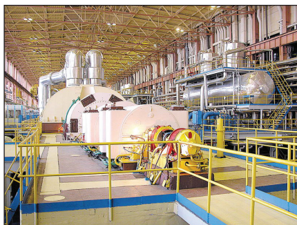
Кольская АЭС. Машинный зал турбинного отделения
