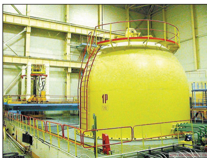
Кольская АЭС. Центральный зал реакторного отделения
