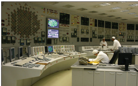
Блочный щит управления Ленинградской АЭС
