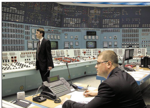
Кольская АЭС. Блочный щит управления
