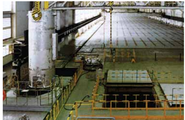
Общий вид «мокрого» хранилища ОЯТ
